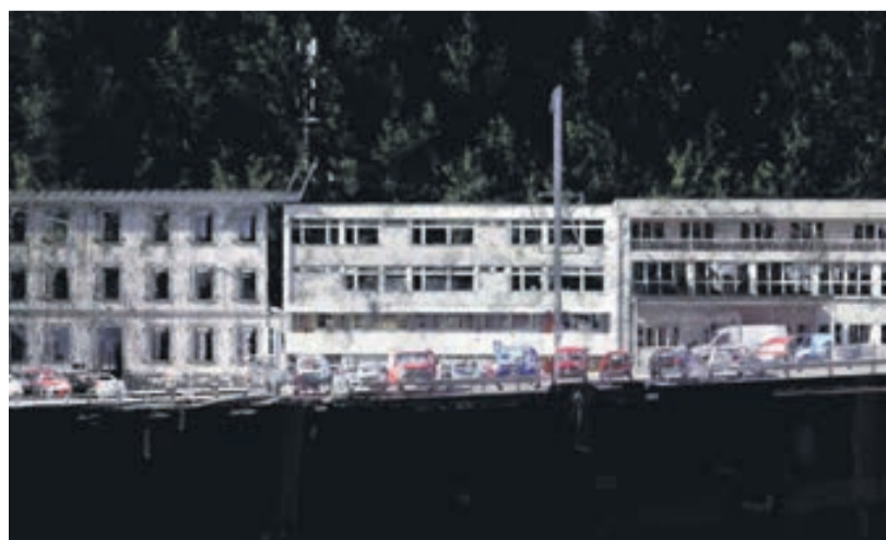
Le bâtiment de Brigue, aujourd'hui délabré, a été construit en 1957 pour effectuer les contrôles médicaux.
