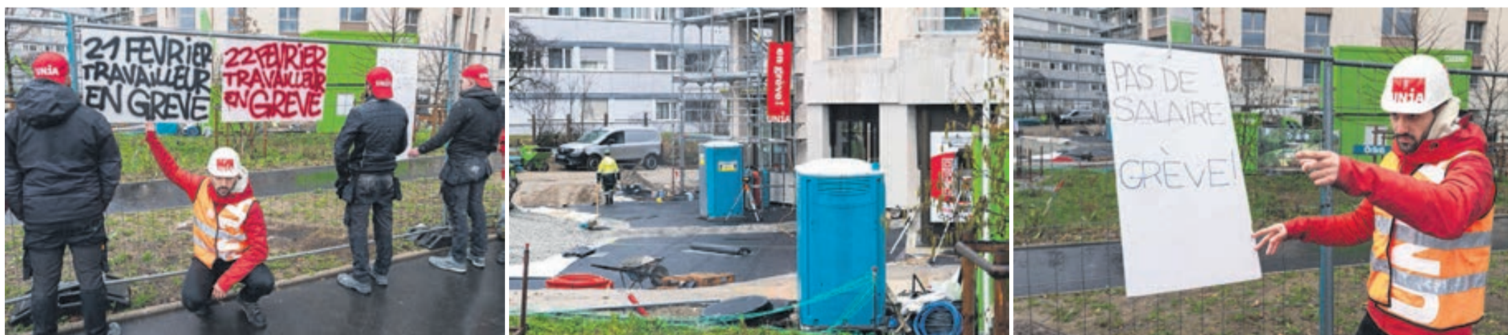
Les trois ouvriers non payés ont décidé de cesser le travail. Après trois jours et demi de grève, ils ont obtenu gain de cause sur ce chantier d'une fondation de Lancy et de caisses de pension.
