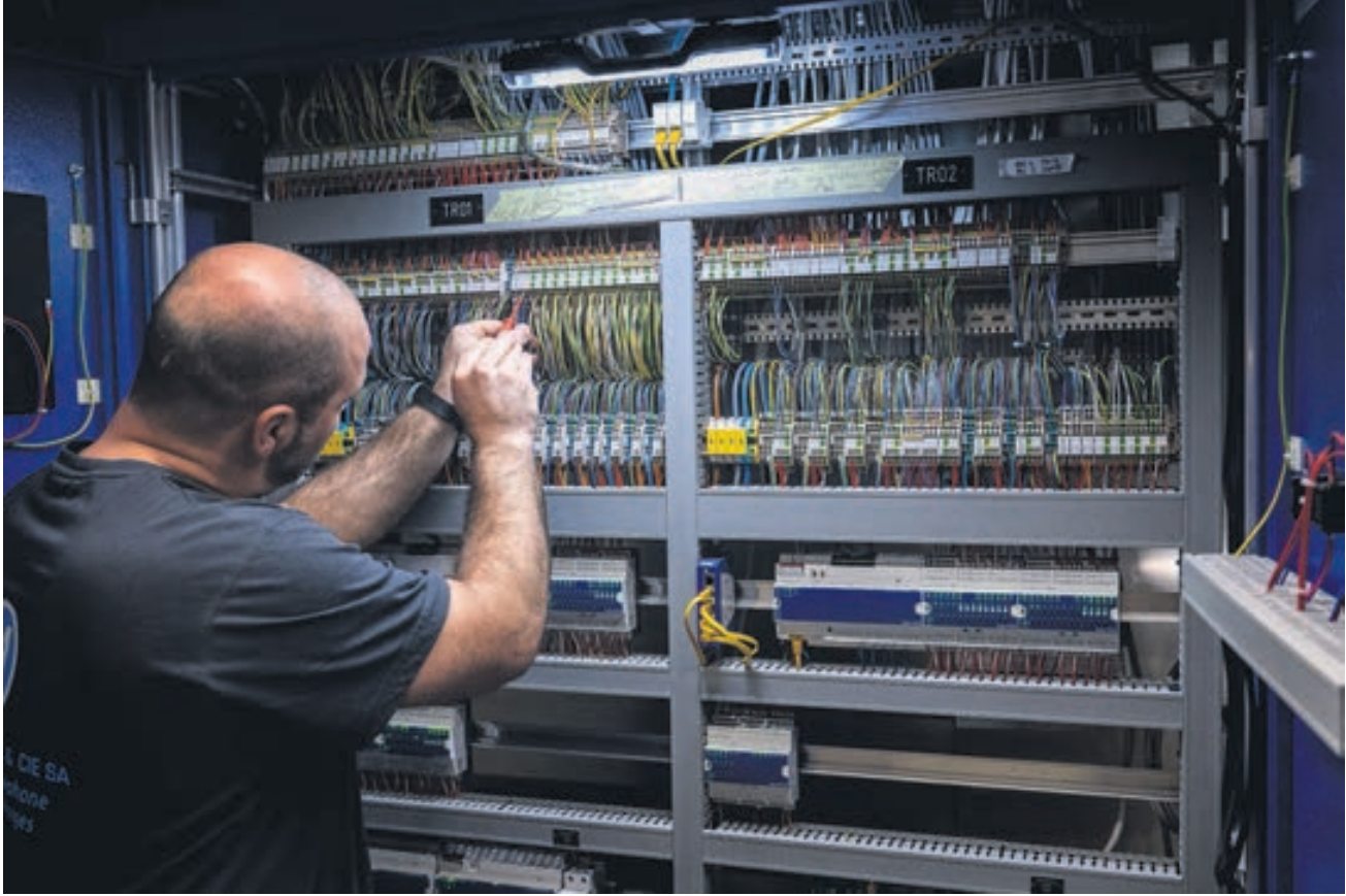
Devant le tableau de régulation du chauffage et de la ventilation, l'électricien au travail.
