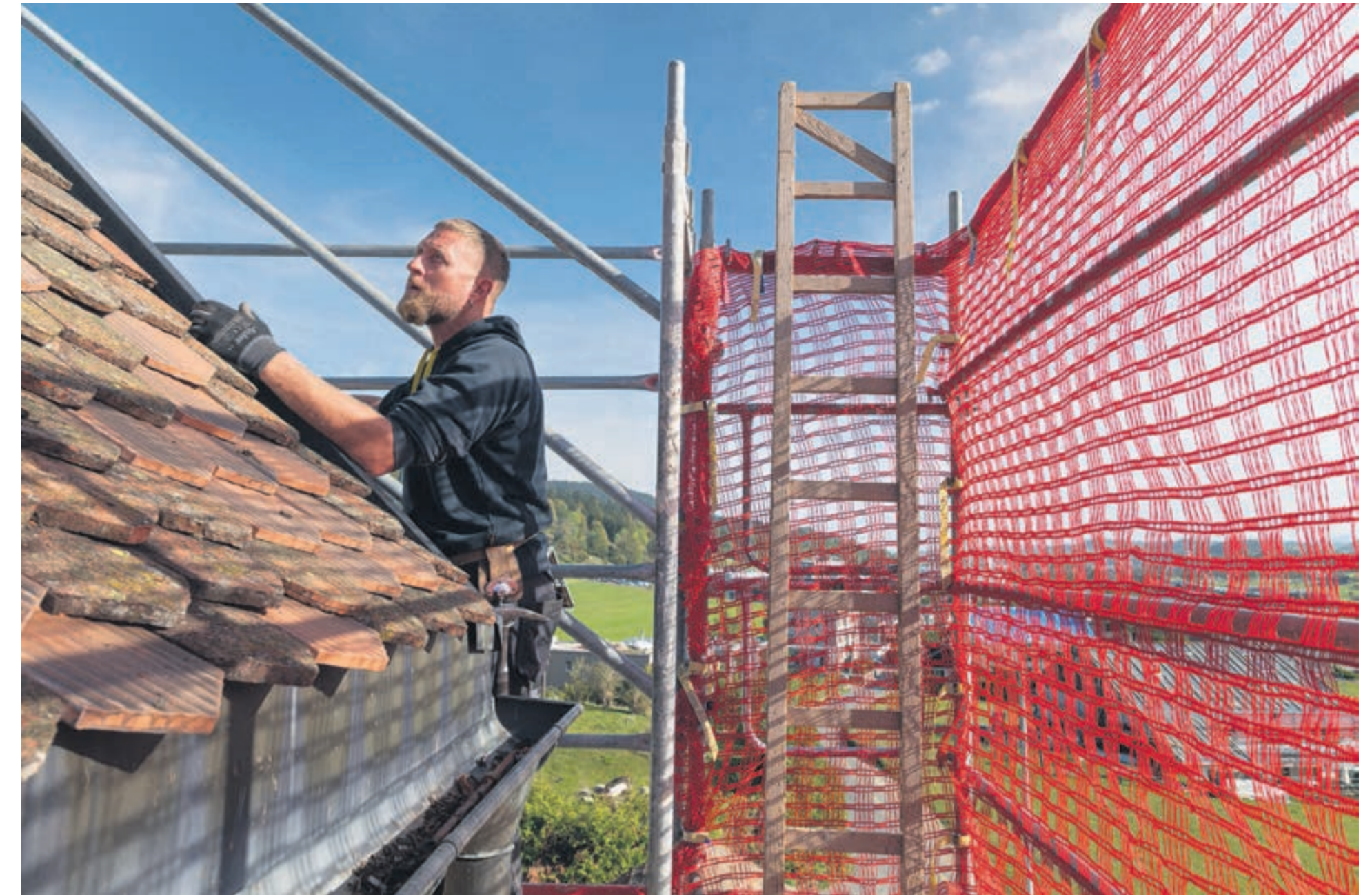
«J'aime la petite tuile, cela me rappelle mon Alsace natale», mentionne Frédéric Vargas, sur le pan sud du toit. Son rêve? «Faire le toit d'un clocher».
