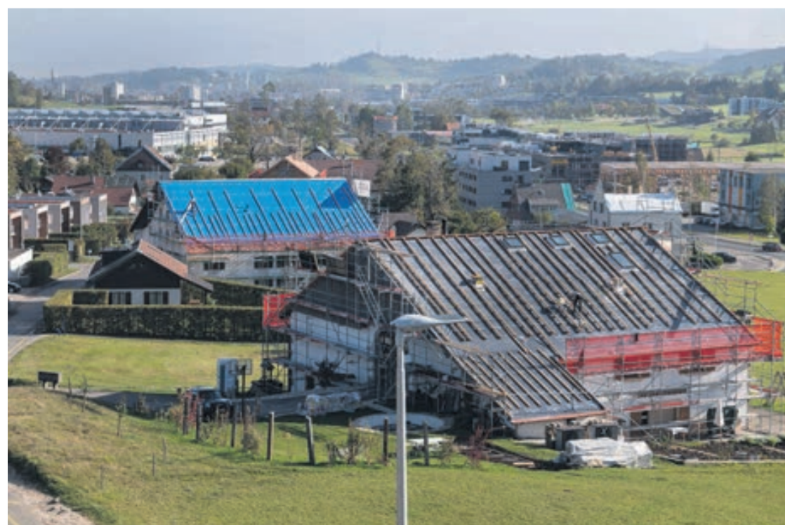
Au Crêt-du-Loche, la tempête a endommagé quasi toutes les maisons. Les réparations vont bon train.
